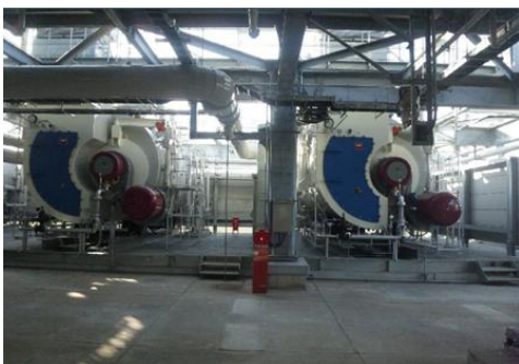
某地域冷暖房殿
